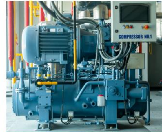
空壓機 Air Compressor
