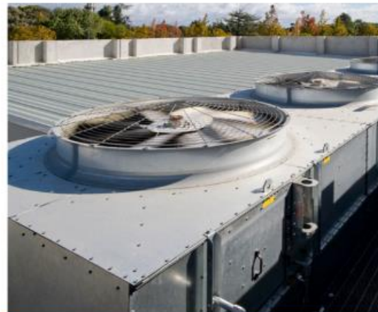
空調系統 HVAC System
