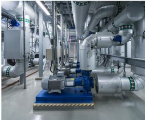
水泵 / 循環泵 Pump
